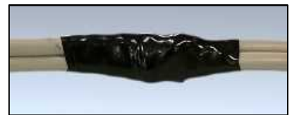
（写真）電源コードのねじり接続
