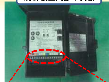
制御装置内部の状態
