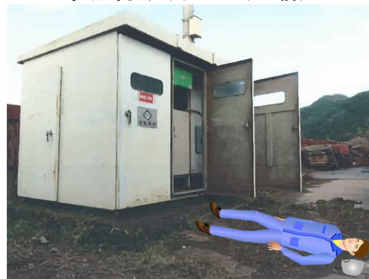
事故時状況（キュービクル前）
