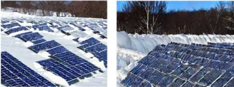
氷雪による太陽光発電設備の破損イメージ ※実際の事故画像ではありません。
