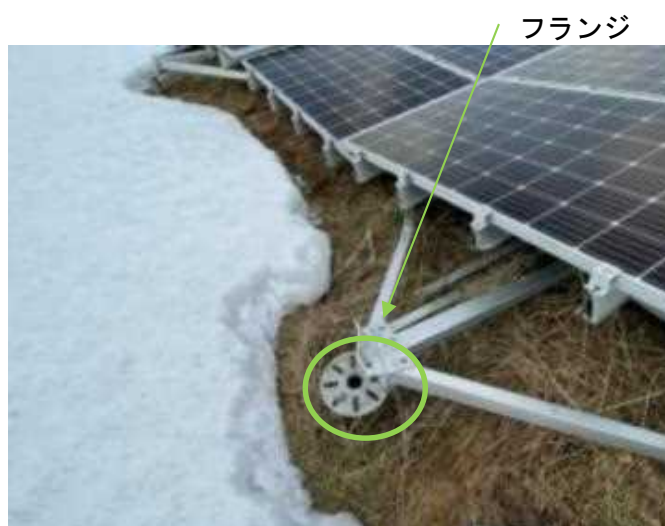
[図 6] 接続部の破断
