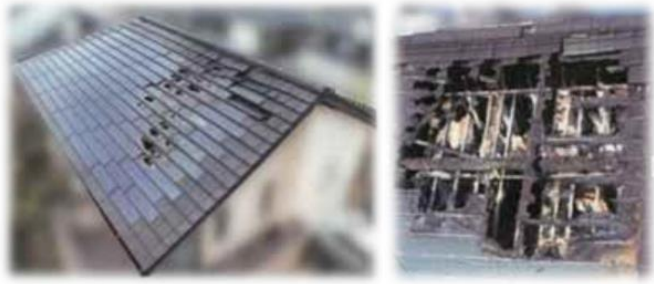
屋根の被災状況（右はモジュール撤去後）イメージ写真
