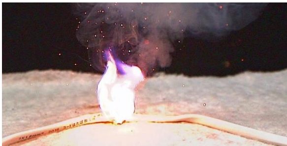
断線した電源コードの発火
