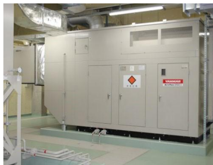
自家発電装置（毎月運転確認を実施）
