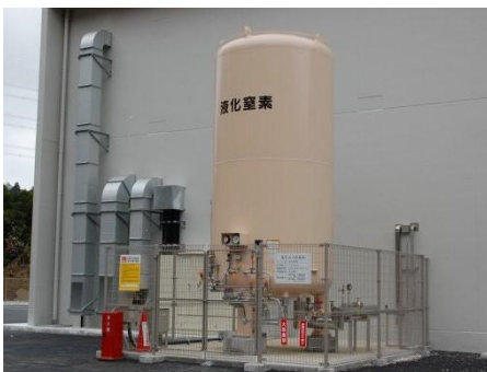
屋外液体窒素補充用タンク
