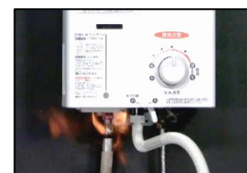
ガス湯沸器のガス接続部から漏れたガスに引火
