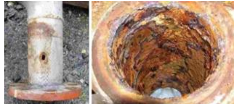
腐食した金属
